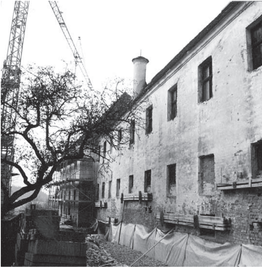
Vom Hausschwamm durchsetzt: Der Prälatengarten mußte von Grund auf restauriert werden.
