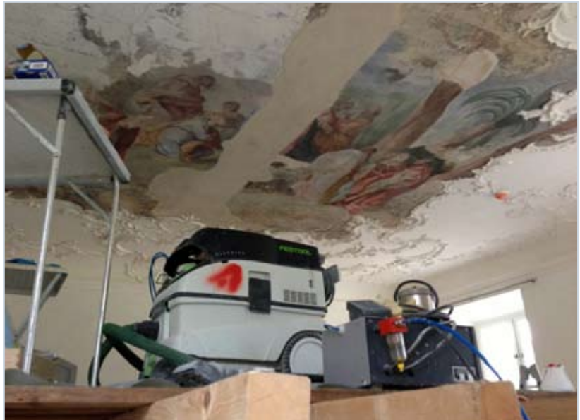
Die Restaurierungsarbeiten des Deckenfreskos im Süd-Ost-Risalit durch die Restaurierungswerkstätten Amann sind noch im vollen Gange.
